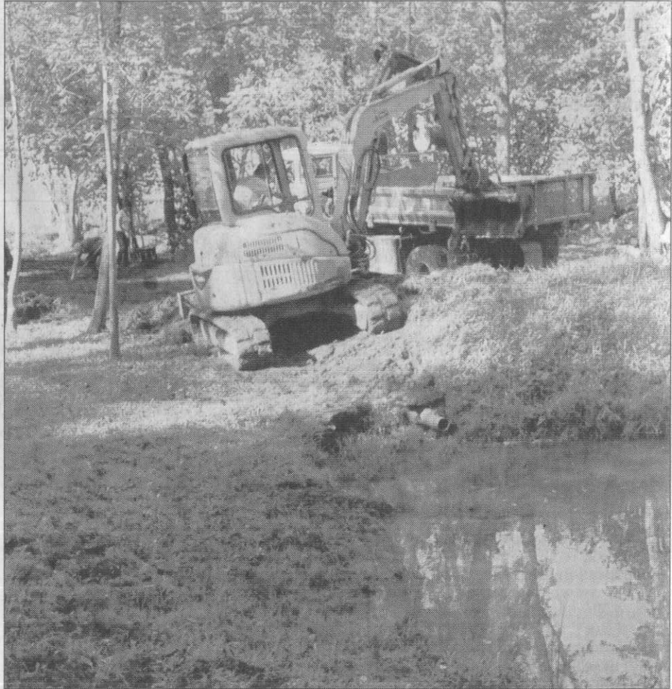
Les trop-pleins ont été canalisés vers la mare voisine / Photo Roger Gros
